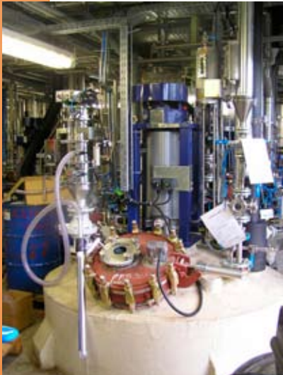
Újonnan installált pneumatikus szállító berendezés
